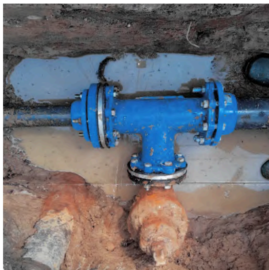
Fuite sur Té collé alimentant la BI
